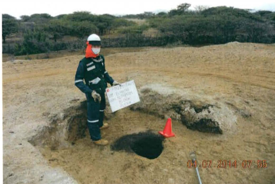
Fotografía N° 3. El pozo T2600, está ubicado dentro de restos de una cantina de concreto deteriorada de 6,76 m 2 x 0,5 m de profundidad.
