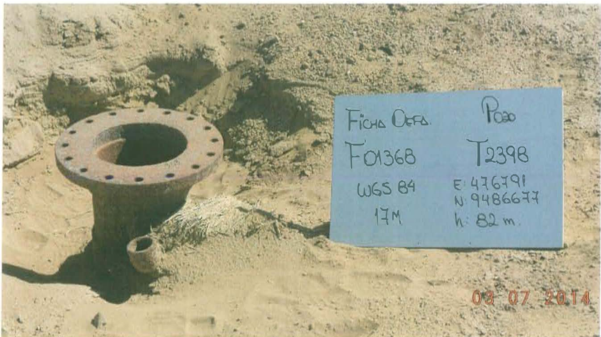
Fotografía N° 2. Se observa pozo inactivo que presenta casing con la parte inferior de la brida se encuentra abierto, sin elemento de cierre tales como válvulas, llaves entre otros, que garanticen un cierre hermético del pozo.
