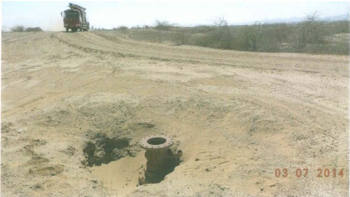
Fotografía N° 1. Ubicación del pozo inactivo en un hoyo, con casing con brida expuesto al ambiente, no señalado ni cercado a 3 m de una trocha carrozable.
