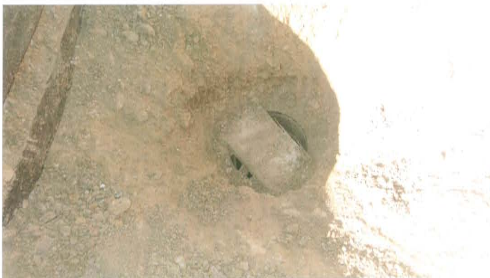
Fotografía N° 2. El pozo presenta casing abierto y parcialmente cubierto con una tabla de madera.
