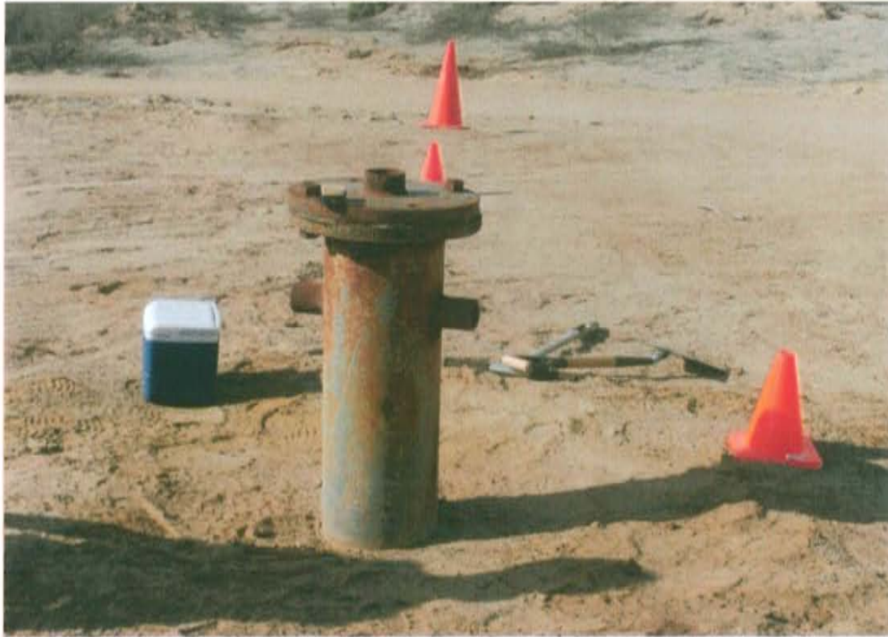
Fotografía N° 1. Pozo L_403 presenta casing corroído abierto y expuesto 0.85m de la superficie del suelo
