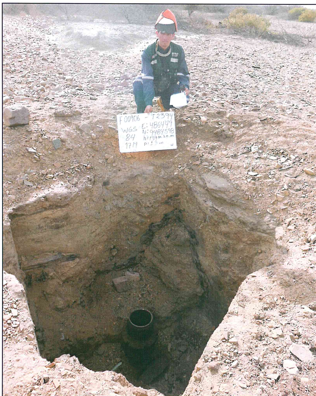
Fotografía N° 1. Pozo T2394 con cabezal que emerge a una altura de 0,7 m desde la base de un hoyo de 1,45 m de profundidad.
