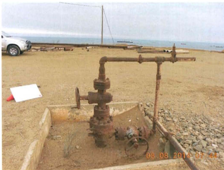
Fotografía N° 3. Se observa cabezal con válvulas y arreglo de tuberías en estado corroído que sobresalen del interior de una cantina derruida
