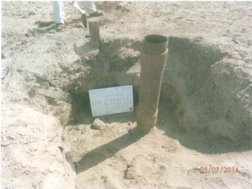
Fotografía N° 1. Pozo inactivo se encuentra abierto y expuesto al ambiente.
