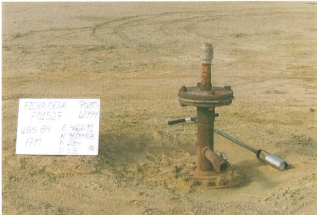
Fotografía N° 3. Se observa válvula lateral posiblemente abierta donde no se asegura su hermétismo.
