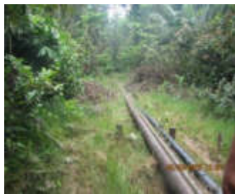
Vista de las líneas de producción Capahuari Norte – Capahuari Sur, que atraviesan el posible sitio en su extremo este.
