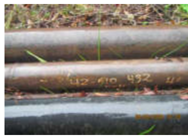
Vista de una unión en una de las líneas de producción Capahuari Norte – Capahuari Sur y cerca de la ubicación de esta se observó iridiscencia en la película de agua y ligero olor a hidrocarburos.
