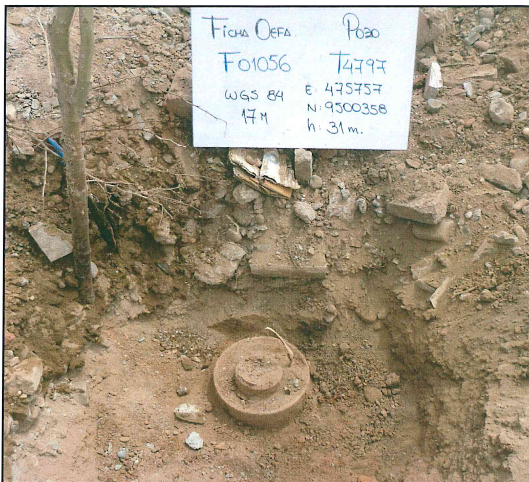
Fotografía N° 1. Pozo T4797 que se encuentra en la base de un hoyo en el que se visualiza tubo de reducción de 6 plg en estado de corrosión.
