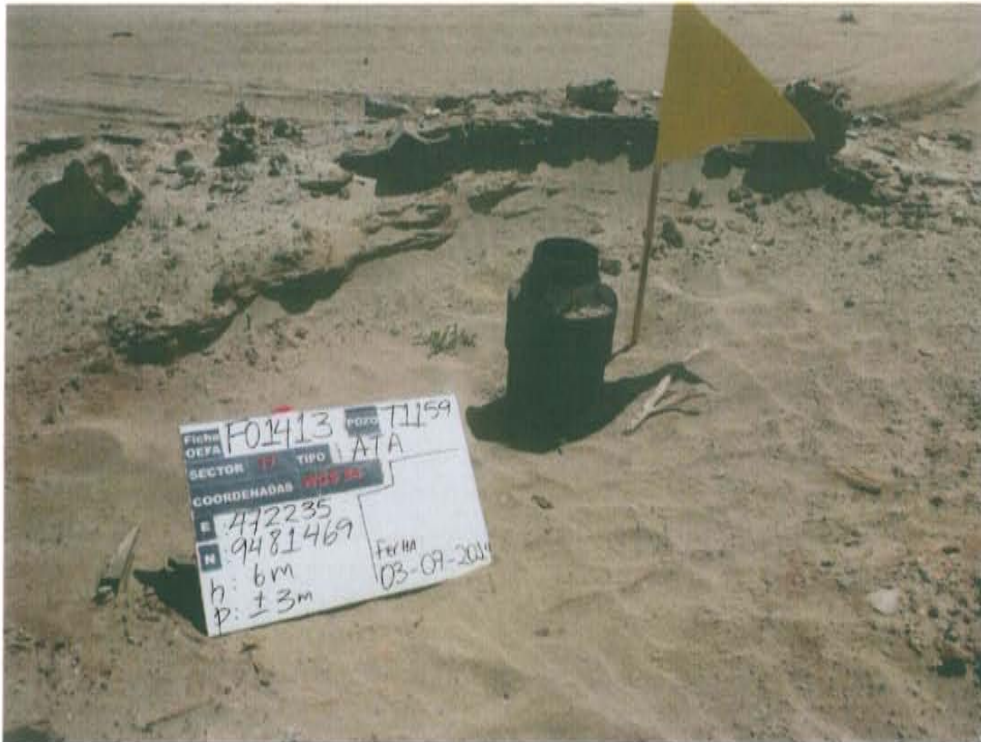
Fotografía N° 1. Se observa casing corroído sin cabezal ni válvulas que aseguren su hermetismo por lo que se considera abierto y expuesto al ambiente.
