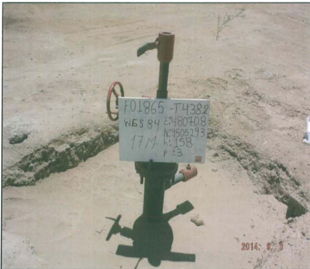
Fotografía N° 1. Pozo inactivo con cabezal compuesto por brida y válvulas, que se encuentra dentro de hoyo relleno con tierra.
