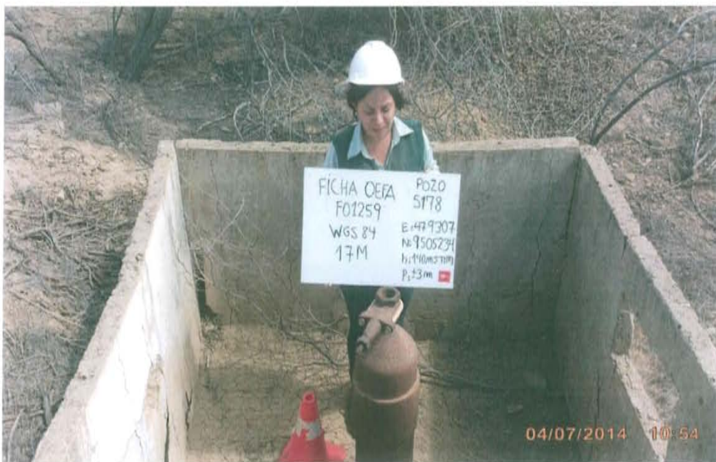
Fotografía N° 2. Vista del pozo, el casing de 9,5 pulg. de diámetro respectivamente, que sobresale aproximadamente 104 m de la superficie del suelo.
