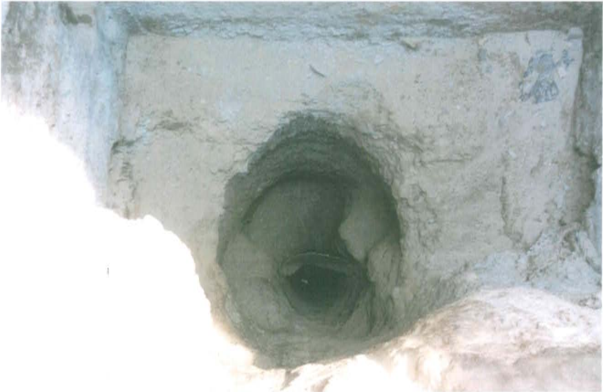
Fotografía N° 01.- Pozo con código PERUPETRO T2428 con Ficha OEFA F01235, se observa el casing dentro de una cantina que no presenta cabezal ni algún accesorio de cierre por lo que se encuentra abierto al ambiente.
