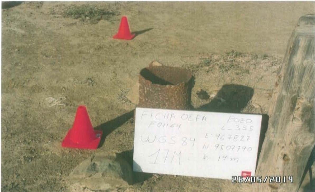
Fotografía N° 01.- Pozo con código PERUPETRO L_355 con Ficha OEFA F01164, se observa el casing corroído sin cabezal ni válvula por lo que se encuentra expuesto al ambiente.
