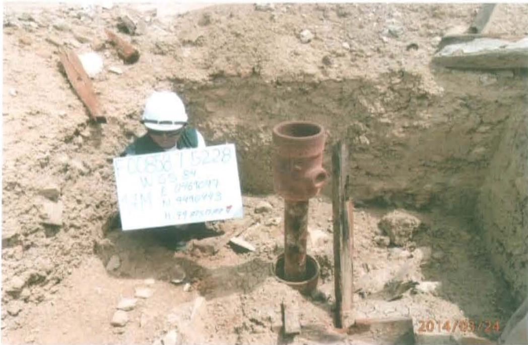
Fotografía N° 1 Pozo inactivo expuesto al ambiente.
