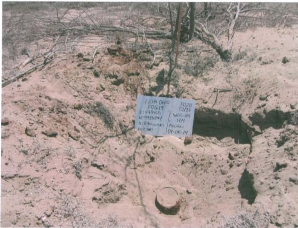
Fotografía N° 1. El Pozo T2127, presenta casing corroído de aproximadamente 8 pulgadas.
