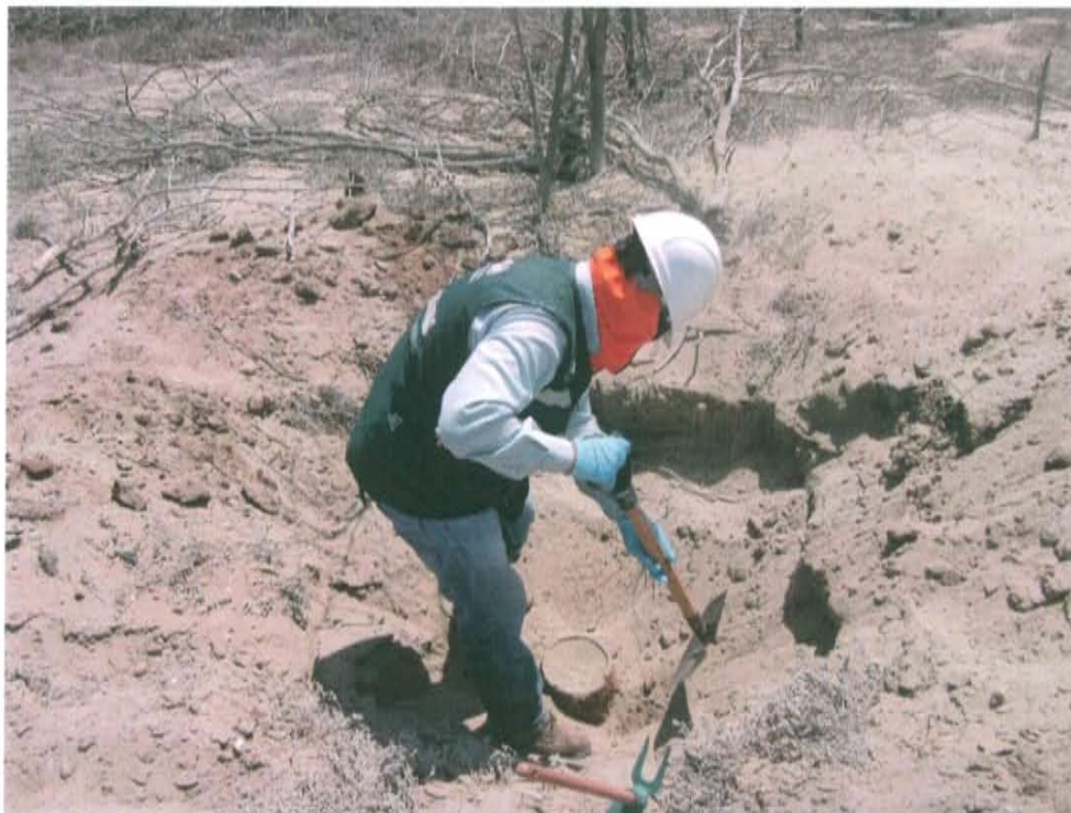
Fotografía N° 3. El Pozo T2127 se encontró enterrado y lleno de arena.
