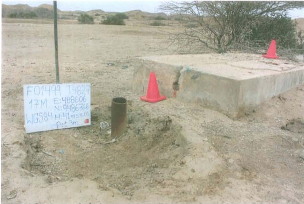
Fotografía N° 1. Pozo T4827, presenta casing de aproximadamente 5½ pulgadas de diámetro abierto al ambiente.
