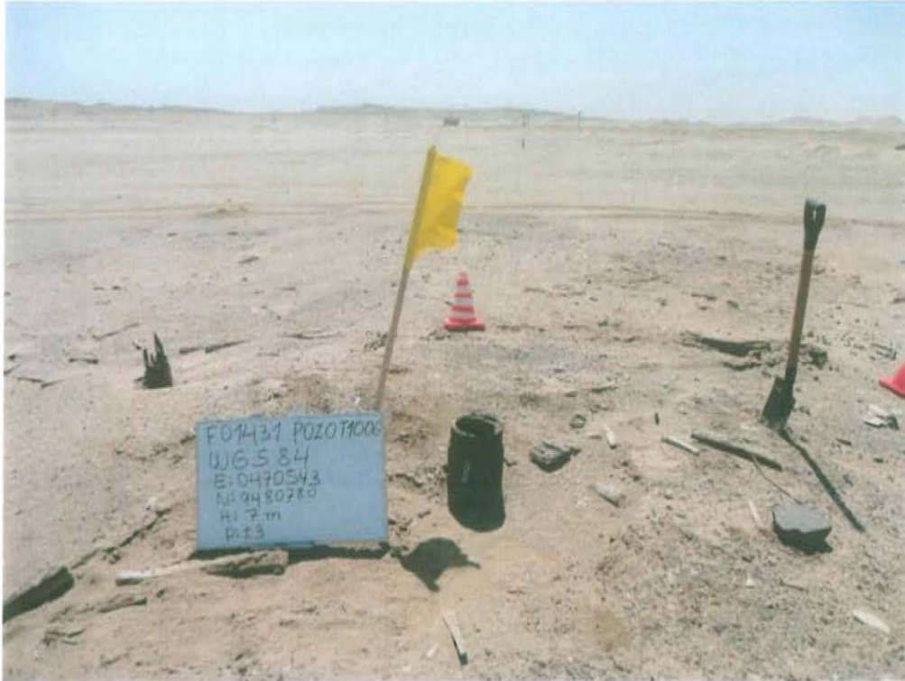
Fotografía N° 1. Pozo T2649 que presenta casing corrido sin brida, sin tapón ni válvula que aseguren el hermetismo del pozo.
