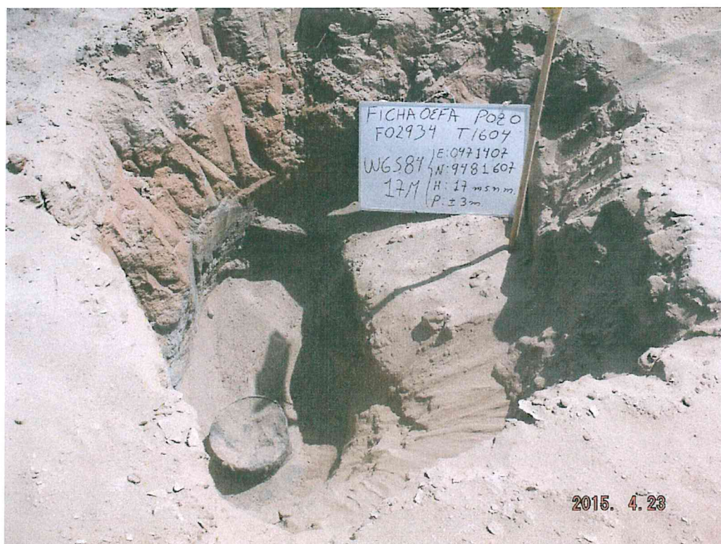
Fotografía N° 2. Se aprecia que el pozo T1604 no presenta elementos que garanticen el cierre hermético del pozo, asimismo se aprecia el casing con tierra en su interior.
