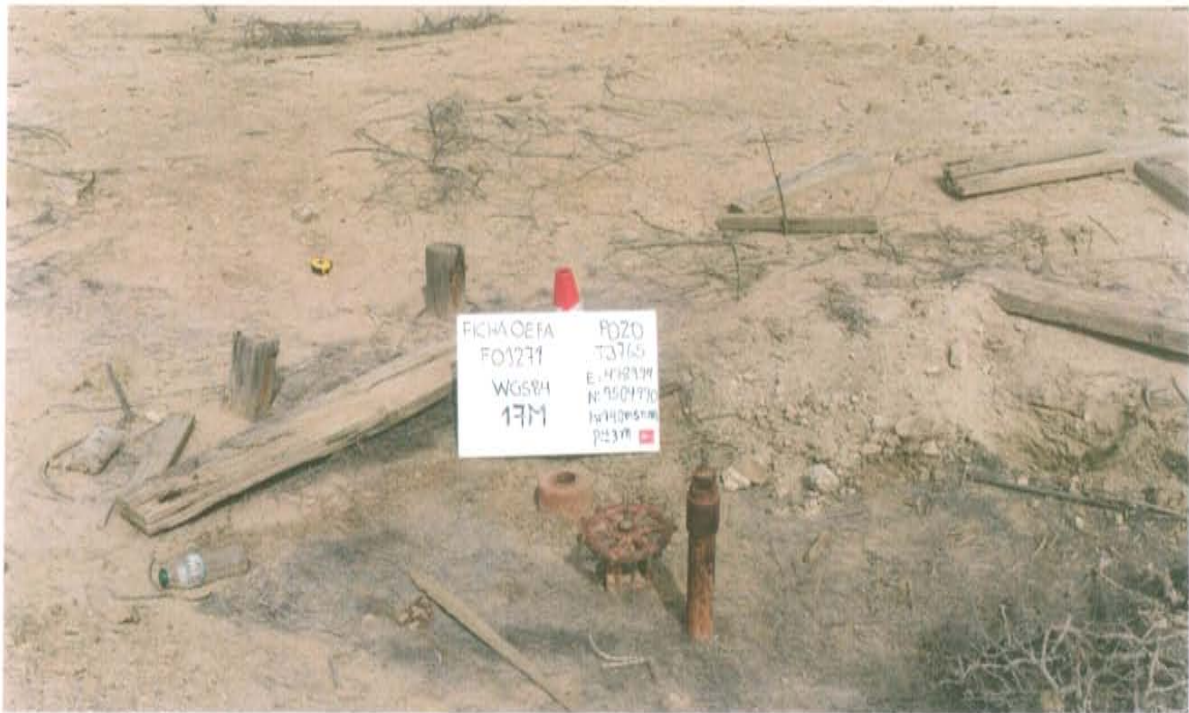
Fotografía N° 1. Pozo con código Ficha OEFA F01271 y con código PERUPETRO T3765, se observa el casing corroído con el tubing expuesto al ambiente; asimismo, se observa una tubería y una válvula de cierre posiblemente pertenezcan a un brazo del pozo.
