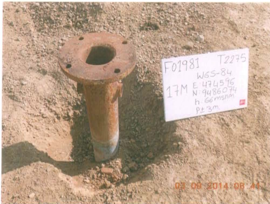
Fotografía N° 1. Ubicación del pozo inactivo ubicado en un terreno plano, se encuentra en estado de corrosión .
