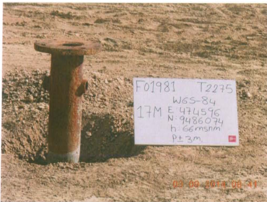
Fotografía N° 2. Se observa pozo inactivo que presenta una casing unido a la parte inferior de la brida, la cual se encuentra abierta, sin elemento de cierre tales como válvulas, llaves entre otros, que garanticen un cierre hermético del pozo.
