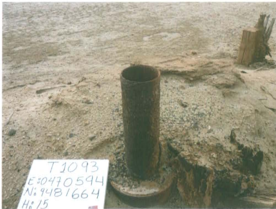
Fotografía N° 1. Pozo T1093, sin cabezal, con casing superficial cementado y casing de producción que emerge 0,65 m sobre el nivel del terreno.
