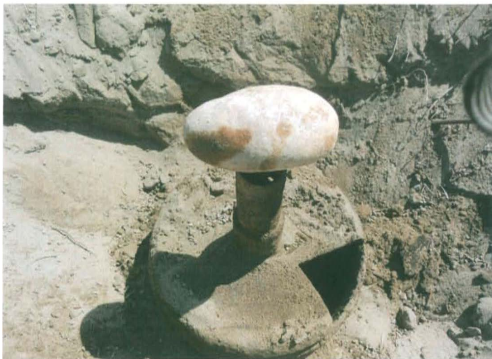
Fotografía N° 01.-Pozo con código PERUPETRO T4267 con Ficha OEFA F01240, se observa la brida cortada y el tubing tapado con una piedra, por lo que se encuentra abierto al ambiente.
