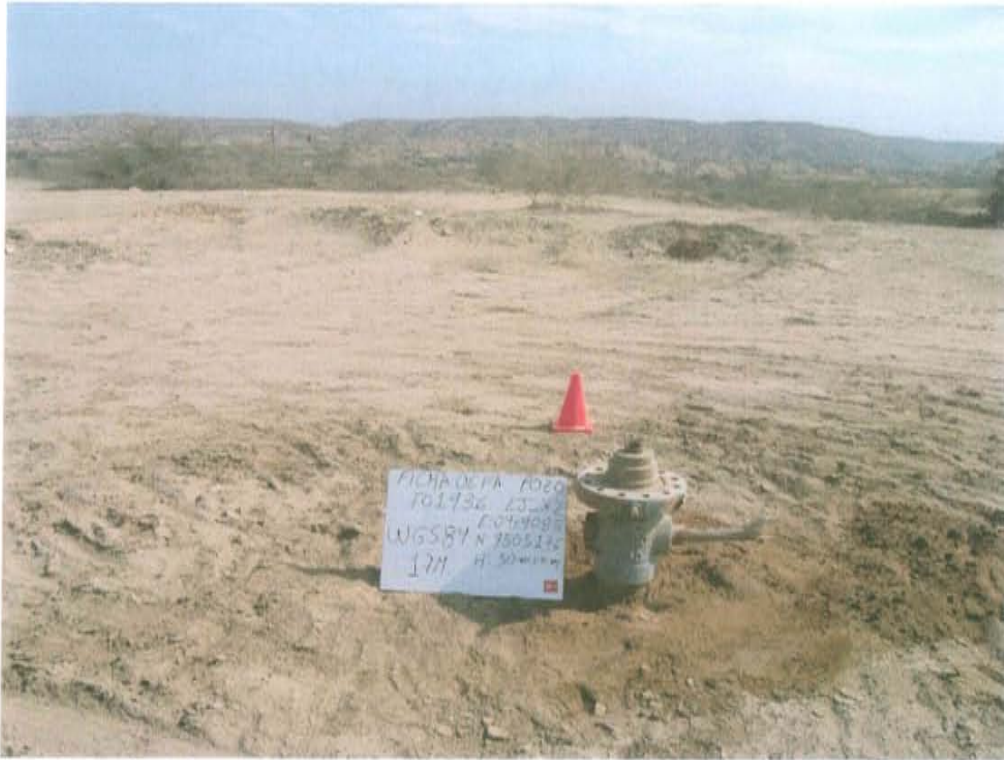
Fotografía N° 1. Identificación del pozo inactivo con código PERUPETRO LJ_X2. Presenta cabezal con brida abierta al medio ambiente.
