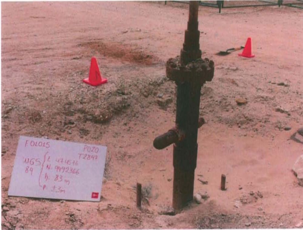
Fotografía N° 1. Identificación del pozo inactivo con código PERUPETRO T2847. Presenta casing corroído y válvula check.
