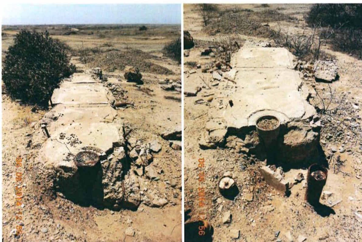
Fotografía N° 3. Se observan 02 vigas monolíticas derruidas ubicadas a 30 m del pozo T2908
