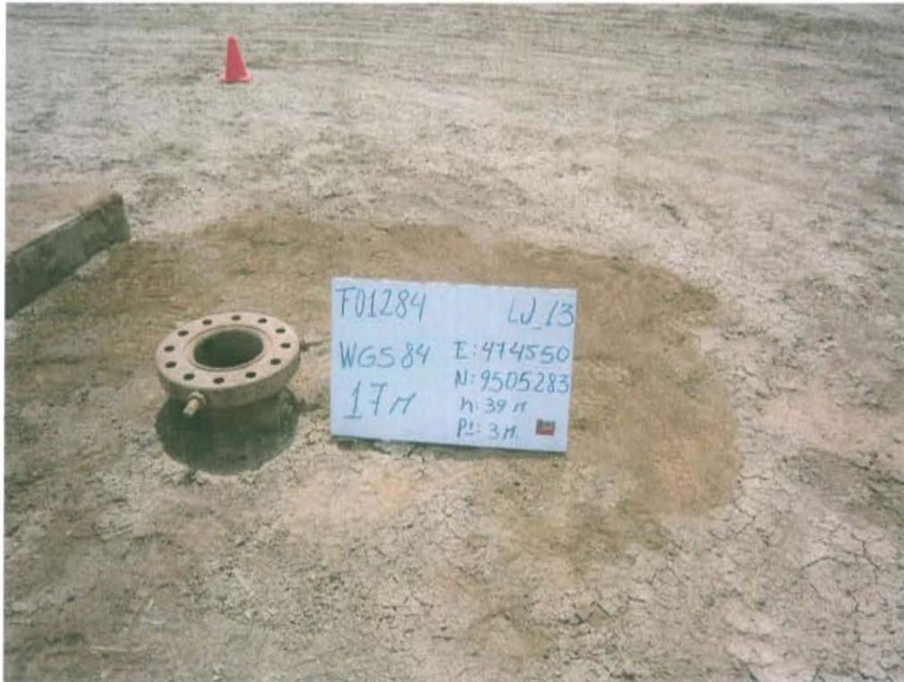
Fotografía N° 1. Identificación del pozo inactivo con código PERUPETRO LJ_13. Presenta casing con brida abierta al medio ambiente.
