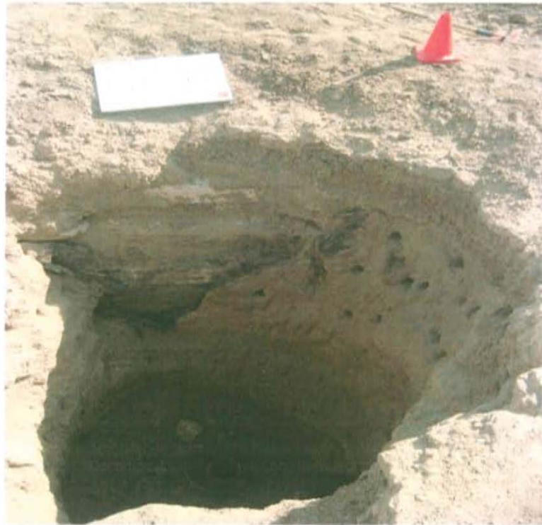
Fotografía N° 01.- Pozo con código PERUPETRO T3620 y con código Ficha OEFA F01914, se observa que el casing y el tubing se encuentra dentro de un hoyo sin cabezal o válvula que asegure su hermetismo por lo que se encuentra expuesto al ambiente.
