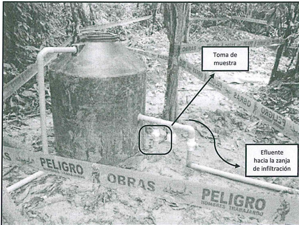
Fotografía N° 1. Punto de monitoreo, efluente antes de su vertimiento a la zanja de infiltración.
