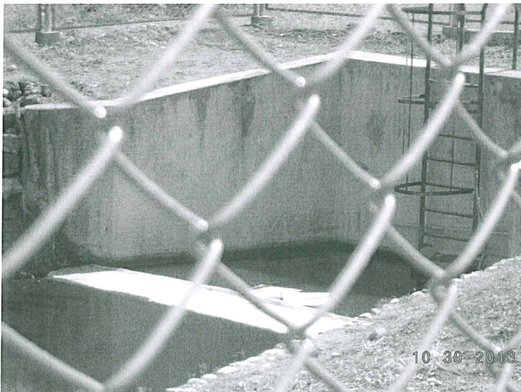
Fotografía N° 6: Punto de descarga del efluente industrial en la poza de oxidación, previo a un tratamiento en la poza API
